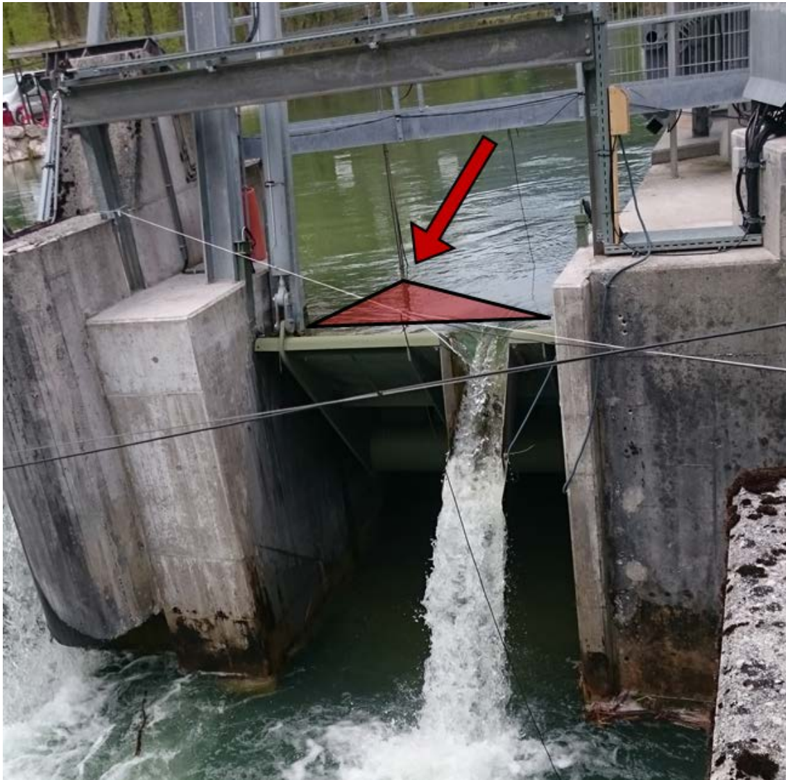
Abbildung 19: Position des DIDSON Sonars (unter der Wasseroberfläche) am KW Ebewe und ungefährer Aufnahmebereich (Abstiegsklappe).
