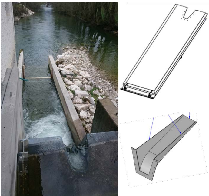
Abbildung 7: Treibgutklappe am KW Laganda mit oberflächlicher Ausnehmung und Fischrutsche (Fischabstiegsklappe). Bild rechts: WWS Wasserkraft/ Plangrundlage KW Laganda.
