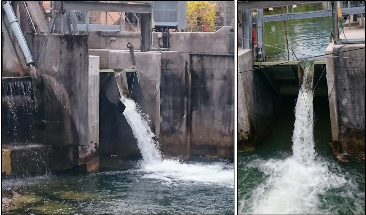
Abbildung 16: Montierte PIT-Antenne an der Fischabstiegshilfe (Öffnung in der Rechenspülklappe) des Kraftwerks Ebewe.
